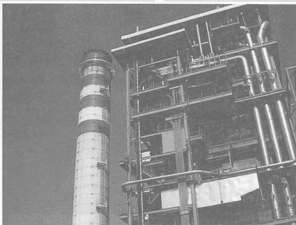
Una centrale termoelettrica
