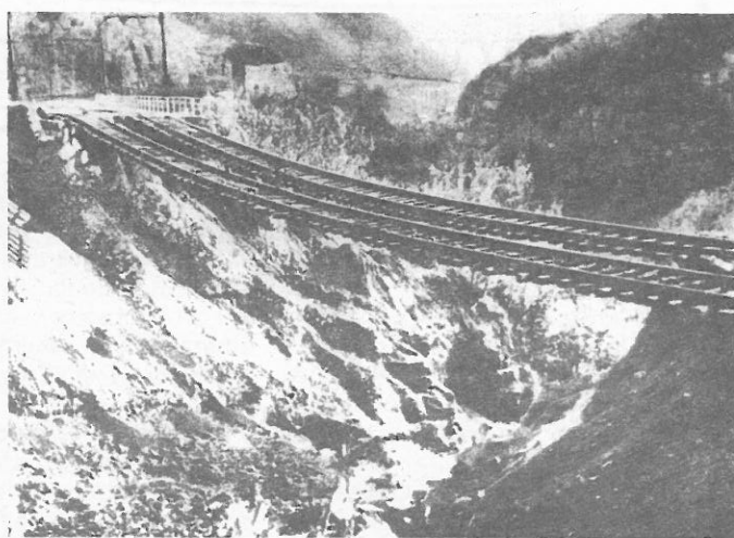
26/10/1954. Crollo del ponte ferroviario tra Cava de' Tirreni e Vietri.
