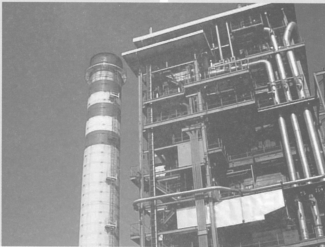
Una centrale termoelettrica
